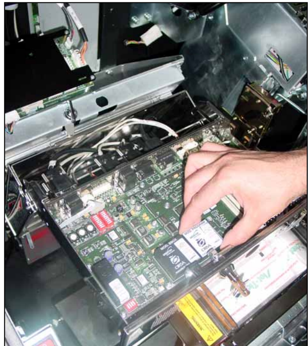
Figura 6.8.d Acceso al interior del rack de control.
